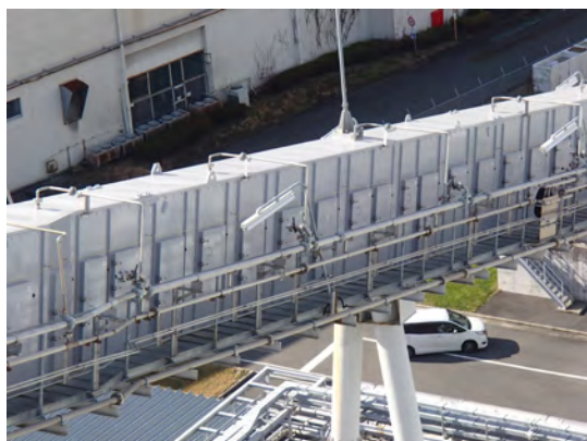
密閉して飛散対策を施した石炭コンベア
