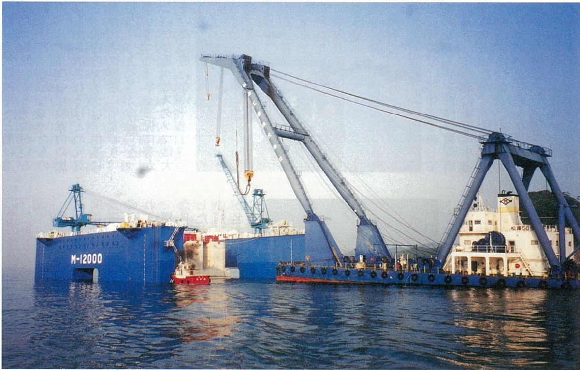
下田港外防波堤用 消波ブロック内蔵双胴型ケーソン完成 8階建ビルに相当
