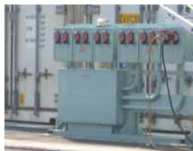
ヤード内にある冷凍電源施設です。冷凍・冷蔵コンテナに使われます。
