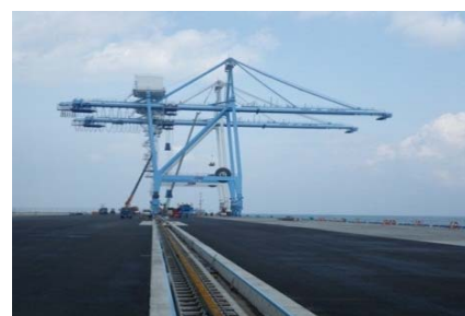
設置完了した新ガントリークレーン
