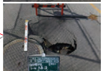
エプロン舗装のひび割れや沈下(最大50cm程度)→エプロン打替・嵩上げ等
