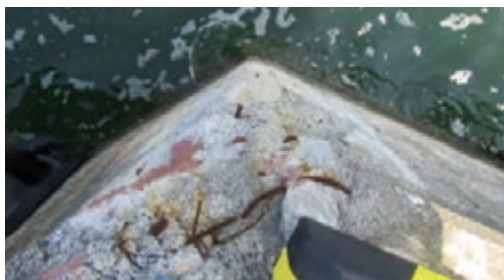
上部工の鉄筋露出→断面補修
